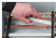
Railkoper afdekking ter afscherming
